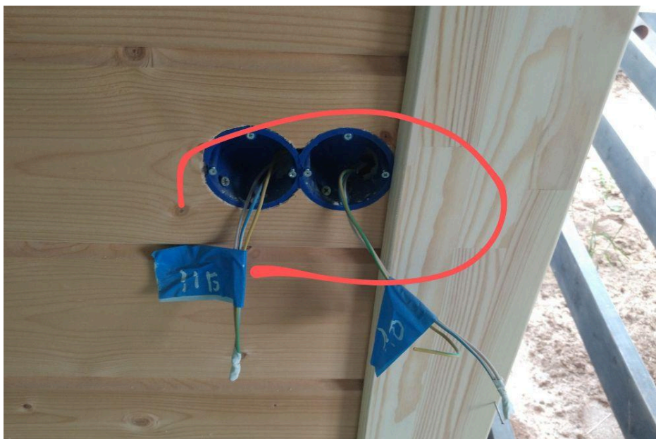
Последствия неправильной привязки, наличник мешает установить финишное оборудование.
